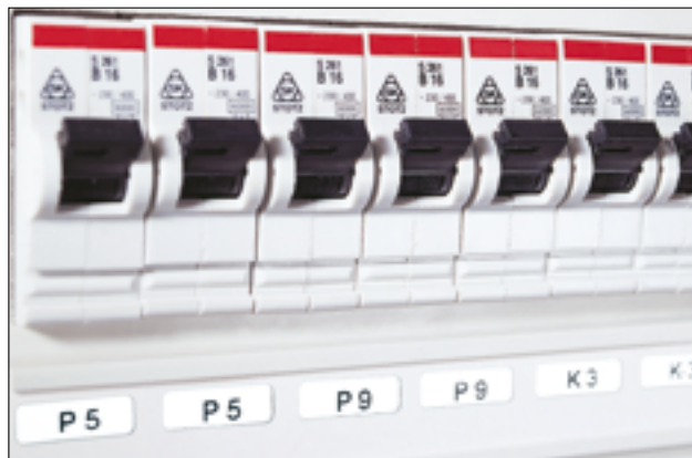
Tydlig og permanent merking av tavler.
