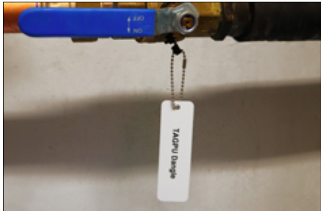
Stort og synlig merking av rør.
