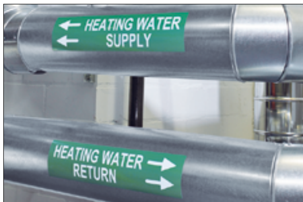
Stort og synlig merking av rør.
